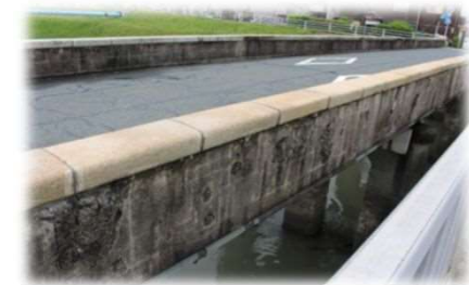
▲龍禅寺町と楊子町間の馬込川にかかる楊子橋です。橋の側面には機銃射撃と思われる弾痕が現在も残されています。
